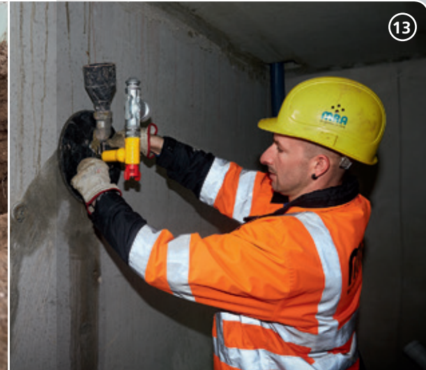
12 Hier wird künftig Erdgas aus dem NBB-Netz die Heizungsanlage versorgen.
