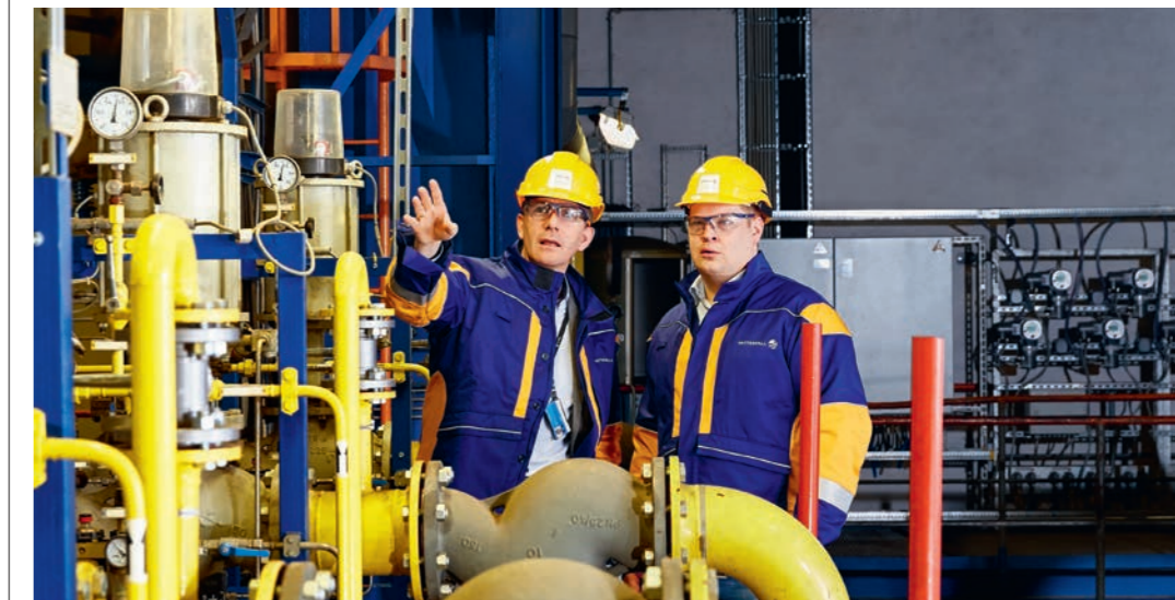
MARKUS WITT (LINKS) UND THORSTEN MELCHER VON VATTENFALL AN DER ERDGAS-EINSPEISEANLAGE AN EINER DER VIER BRENNKAMMERN IN KLINGENBERG.
