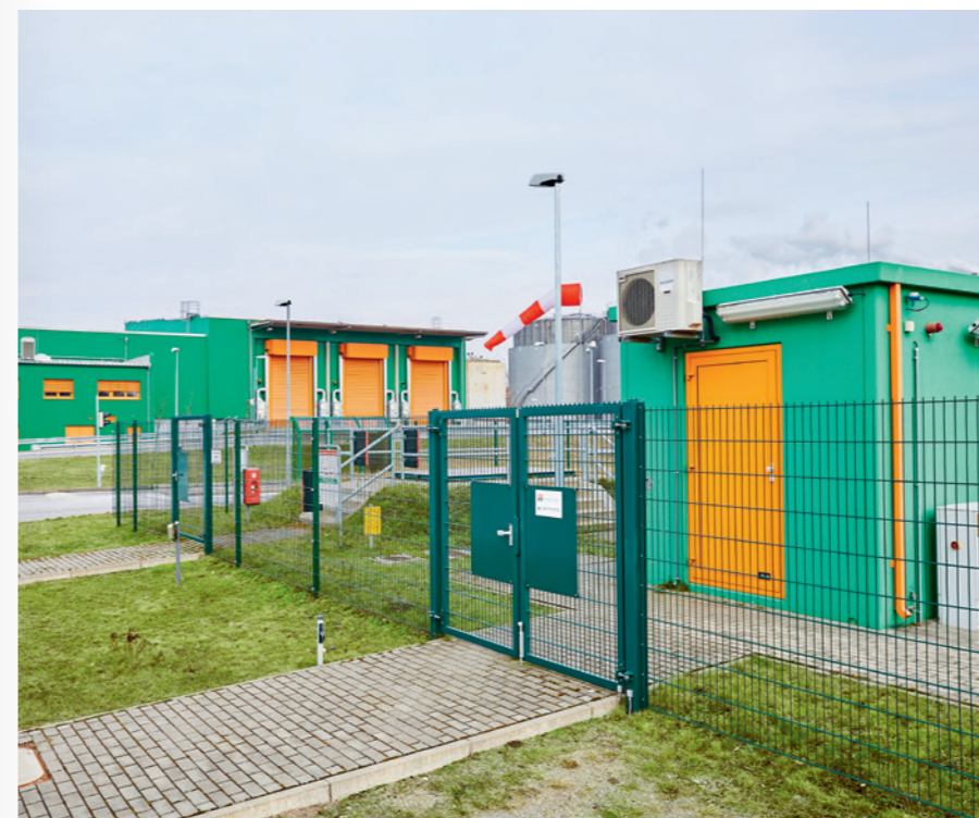
ÜBER DIE EINSPEISESTATION WIRD DAS AUS DEM BIOGAS ERZEUGTE BIOMETHAN IN DIE BERLINER GASNETZINFRASTRUKTUR EINGESPEIST.
